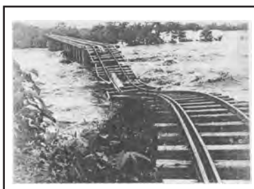
洪水で落下した橋桁
